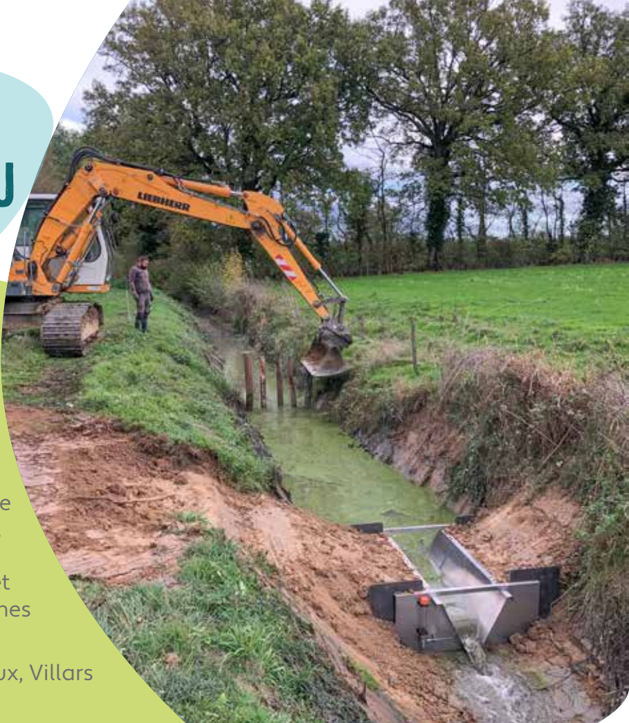
Installation d'un canal venturi à Joyeux
